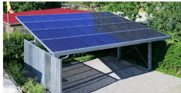
Panneaux solaires capables de générer plus de 37,5 kW
